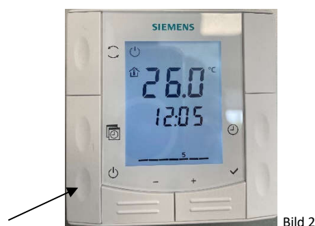
Bild 2 | Sommerbetrieb (erkennbar an dem Standby-Symbol oben links im Display)
